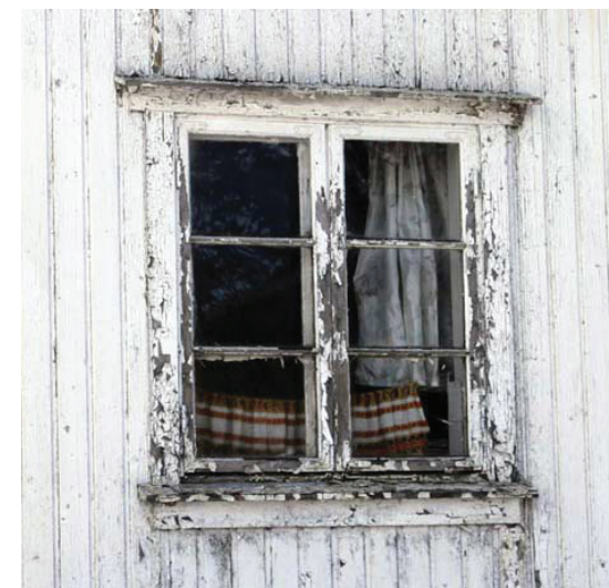
Forfallet har kommet langt, men vinduet har stått i 80 år. Litt ny linoljemaling og de er like nye igjen! Foto: CEWG
