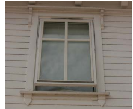
Dette vinduet har feil hengsler og ikke riktig oppdelt
