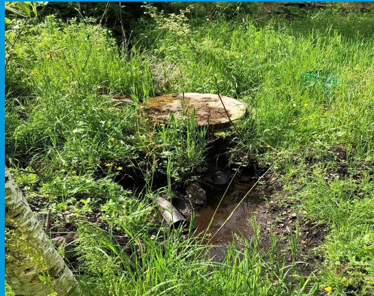
Oppstuvning av avløpsvann rundt slamavskiller
