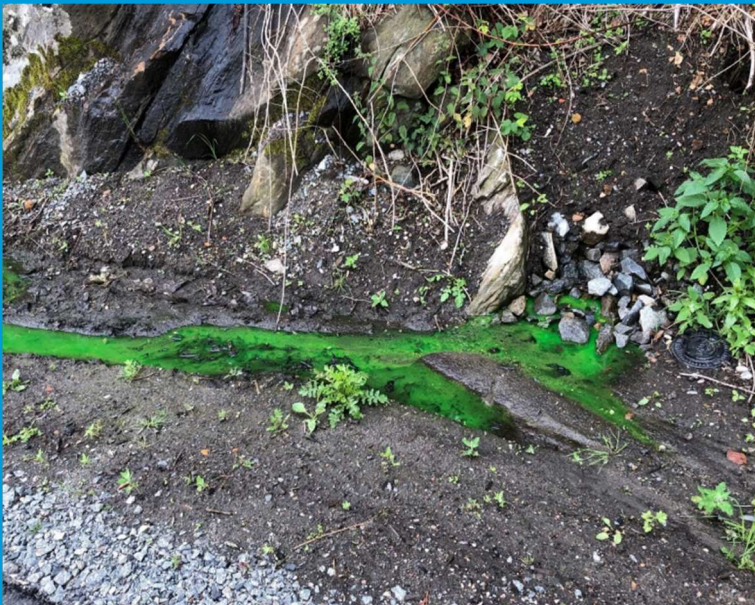
Farge tilsatt slamavskiller for påvisning av lekkasje ut i terreng.
